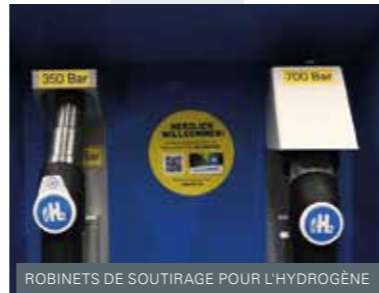
ROBINETS DE SOUTIRAGE POUR L'HYDROGÈNE
