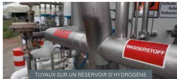
TUYAUX SUR UN RÉSERVOIR D'HYDROGÈNE
