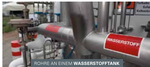
ROHRE AN EINEM WASSERSTOFFTANK
