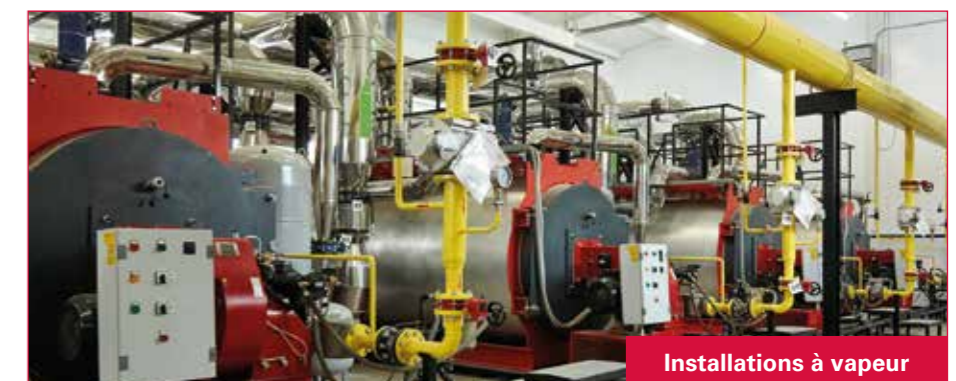
Installations de chauffage
